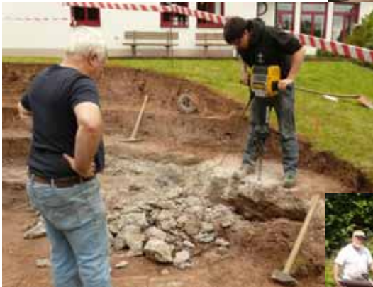
Steine und Betonreste mussten in mühsamer Kleinarbeit mit einem Presslufthammer zerkleinert werden.
