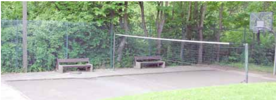
Das Kleinspielfeld in Herschweiler-Pettersheim muss dringend saniert werden.
